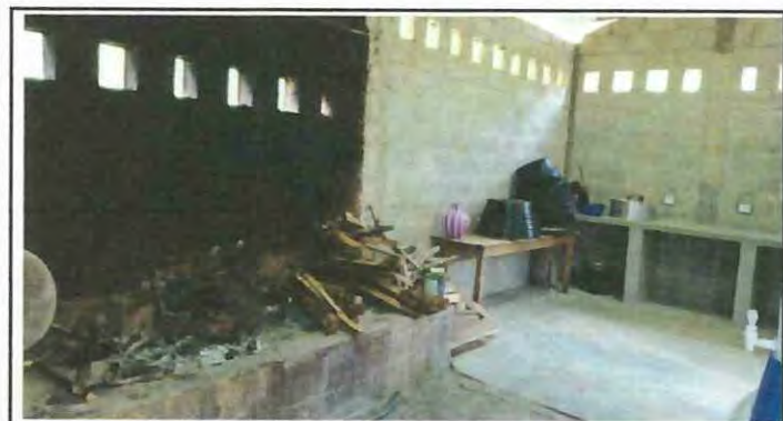
Foto 4: Mantenimiento a estufa rural.
